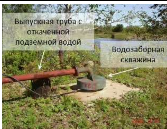
Рис. 11.28. Эксплуатационные водозаборные скважины
